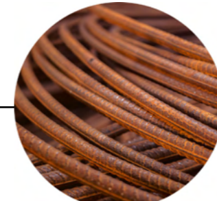
Fig. 318- Rusted steel rods (Karwat, 2015: online)
